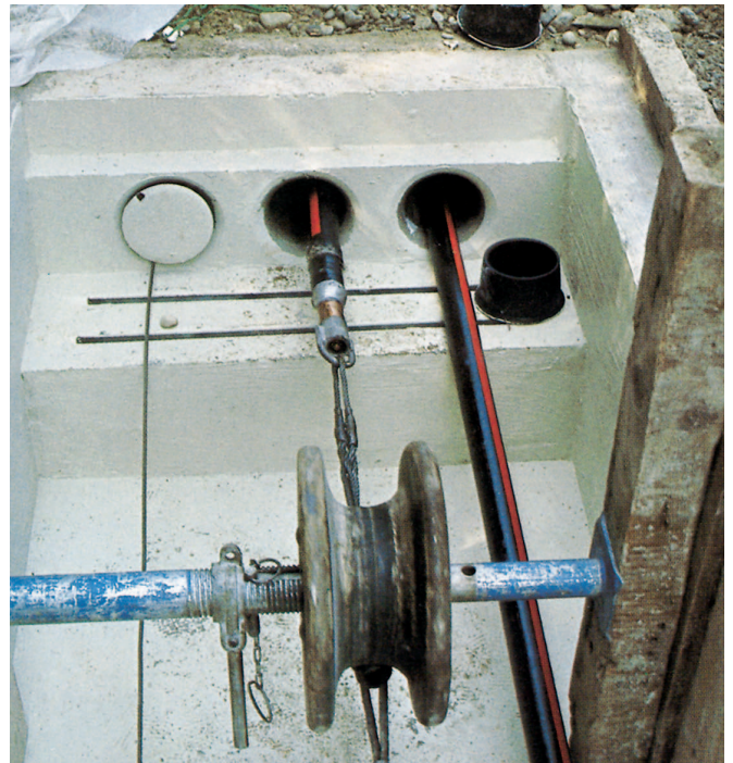
Kunststoffrohranlage mit Muffenschacht.
